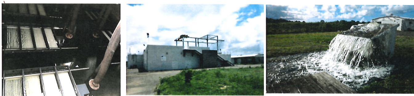
Figure 42: STEU Lalanne - Port-Louis : membranes, ouvrage, effluent traité
