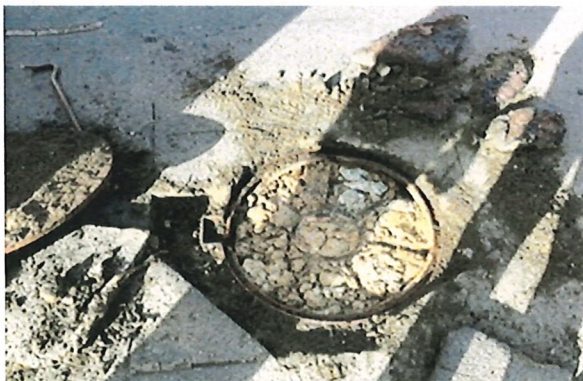
Figure 31: Exemple de bouchon de graisse sur le réseau d'assainissement
